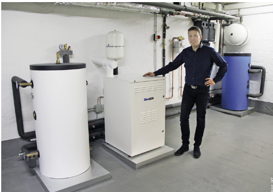
Joachim Scheel zeigt die Brennstoffzelle, die 2018 im Keller des Betriebs installiert worden ist.
